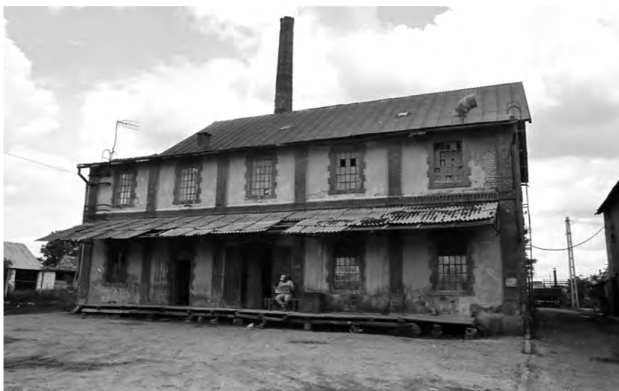
Fig. 4. Clădirea principală a morii, într-o stare de conservare pusă sub semnul întrebării, și a coșului de fum în planul îndepărtat. Imagine surprinsă cu ocazia unei vizite pe teren, în vara anului 1996 [Colecția MȚC (c)]. Arhitectura clădirii a fost restaurată, iar coșul de fum demolat.
